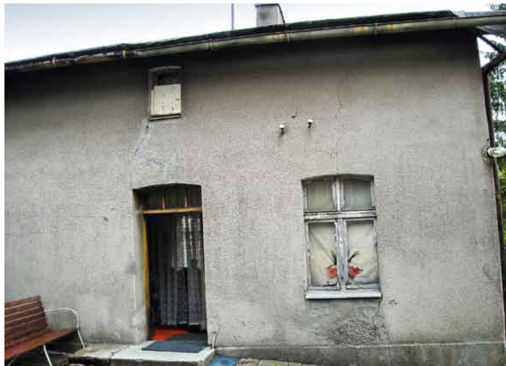
Dach od wewnątrz podtrzymują drewniane belki, w czasie deszczu w przedpokoju powstaje kałuża, a pani Maria przed laty straciła obie nogi
